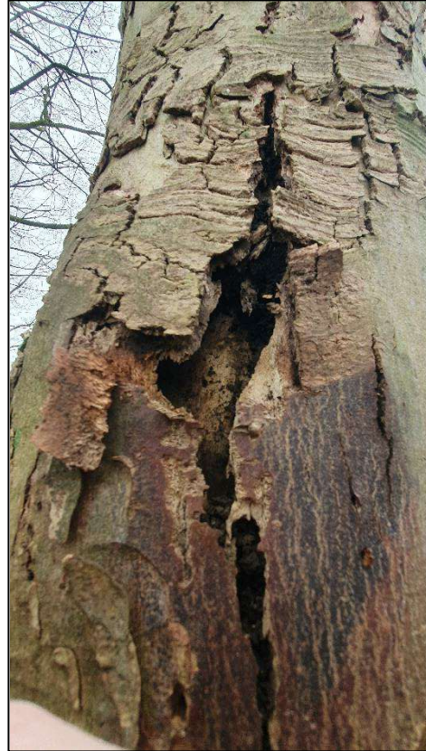
Abbildung 9: Faulstelle in Ahorn
